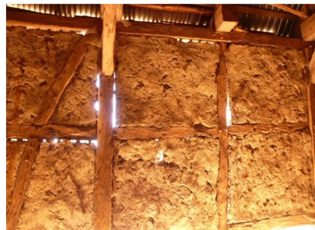
Innenansicht: Der Lehmputz ist etwas geschrumpft und brüchig geworden.
