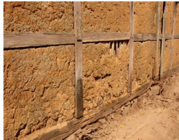
Außenansicht: Fachwerk mit Flechtwerk und Lehmputz. Im Außenbereich wird man einige Balken austauschen müssen.
